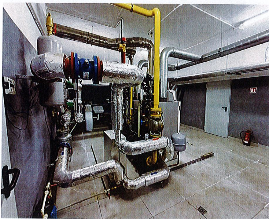
Kotłownia gazowa przy ul. Nowy Świat 12 w Pińczowie
