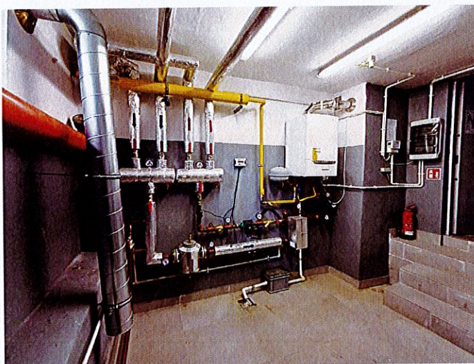
Kotłownia gazowa przy ul. Floriańskiej 2 w Pińczowie
