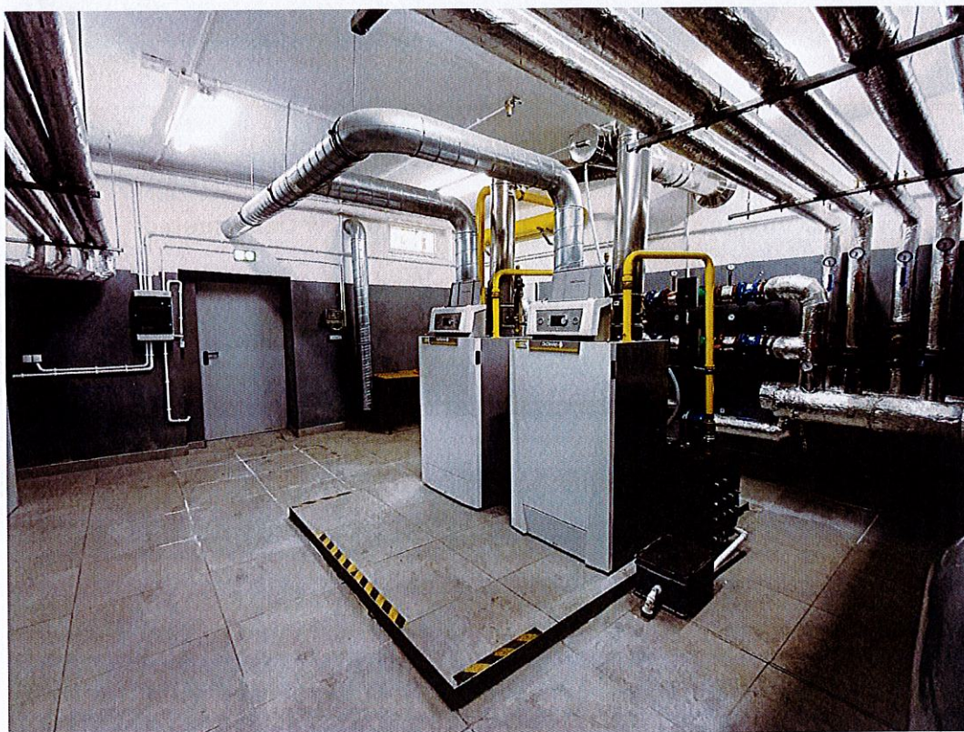
Kotłownia gazowa przy ul. Nowy Świat 12 w Pińczowie
