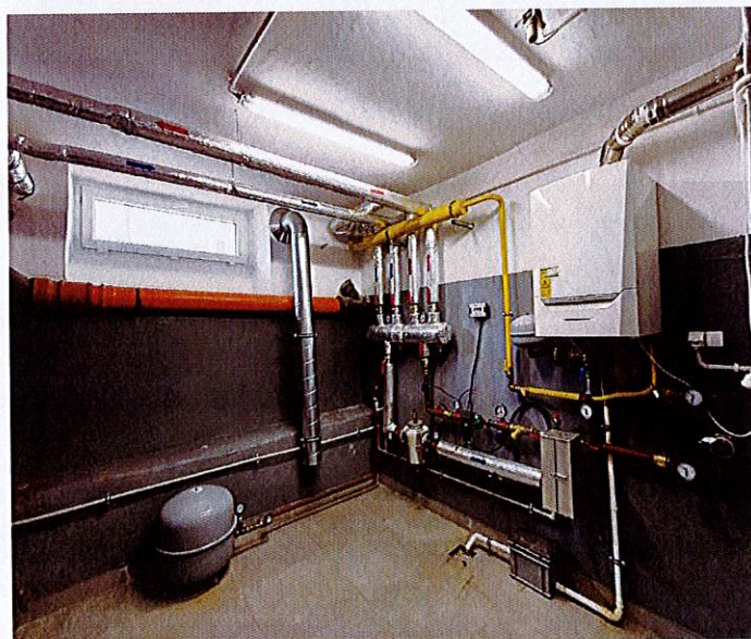
Kotłownia gazowa przy ul. Floriańskiej 2 w Pińczowie
