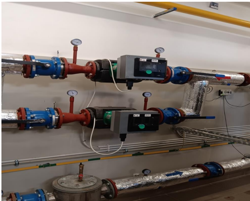
Kotłownia gazowa przy ul. Klasztornej 10 w Pińczowie
