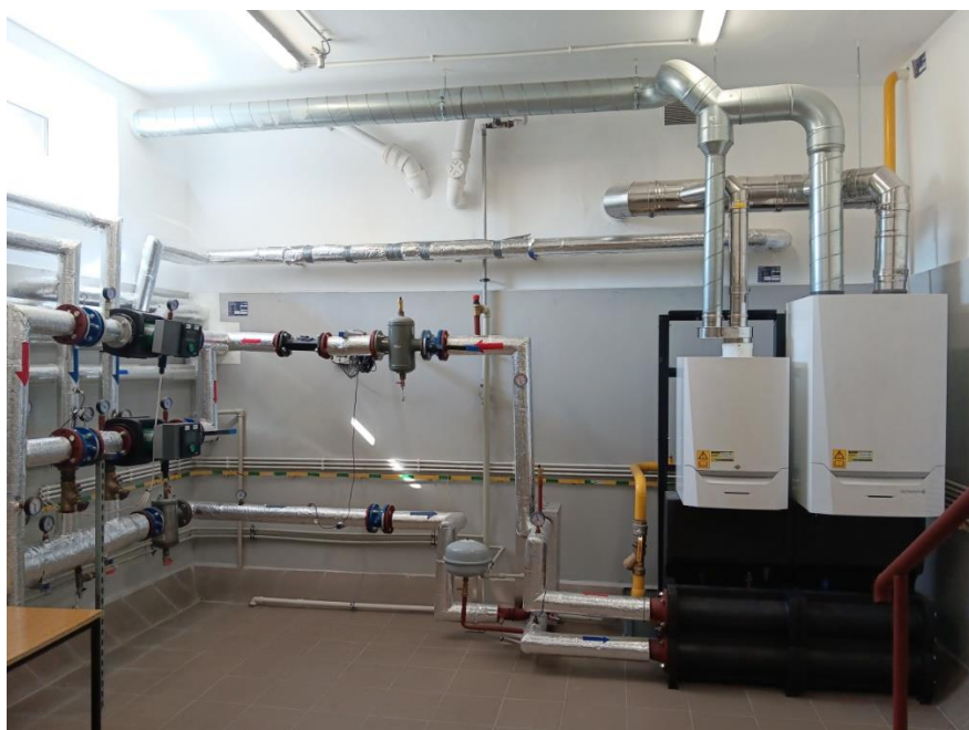
Kotłownia gazowa przy ul. 1 Maja 1 w Pińczowie
