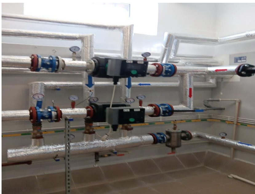
Kotłownia gazowa przy ul. 1 Maja 1 w Pińczowie
