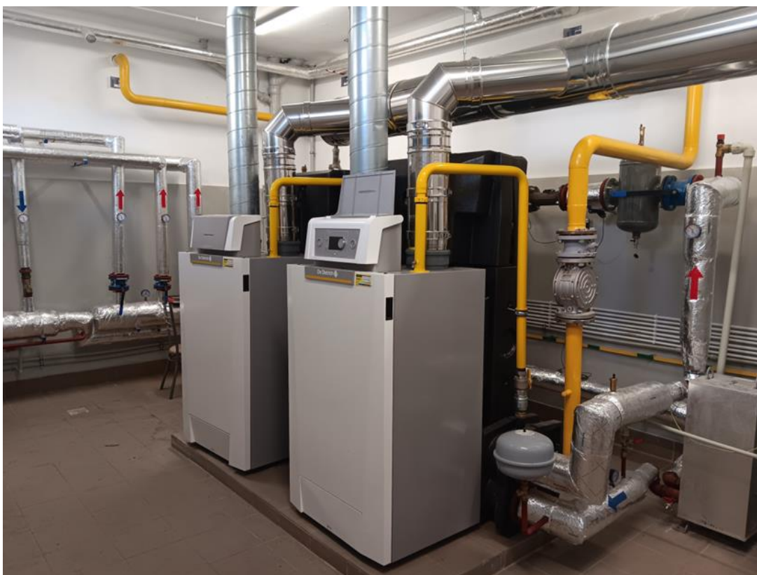
Kotłownia gazowa przy ul. Klasztornej 10 w Pińczowie
